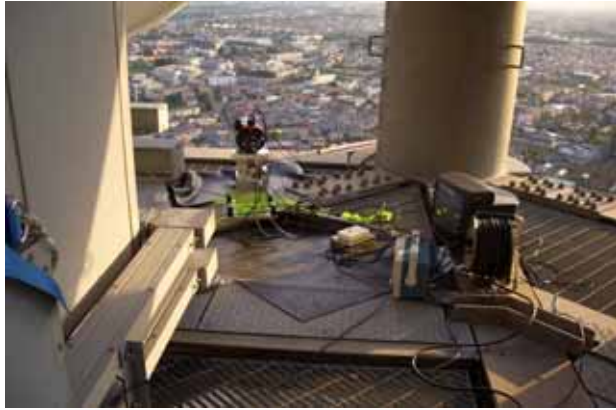
図1 田無タワーに設置された受信側機器
